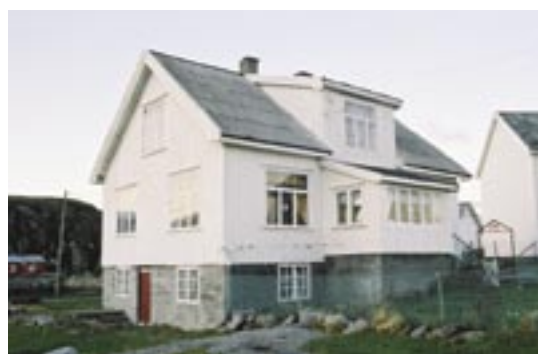
T.h: Bølgeeternitt-tak på etterkrigsbolig på Flatholmen. Nederst: Grønnmalte bølgeblikktak er det mange av på Sør-Gjæslingan. Bølgeblikket rustet pga. havsaltet. Spesielt er nedre deler av taket langs rafta utsatt for rustskader: Se nederst til høyre. Knappe takutstikk er vanlig på de fleste bygningene i fiskeværet. Slik unngår man at kraftige vinder "får tak i" og skader eller fjerner tak. Alle foto på denne siden: Pia M. Gravbrøt
