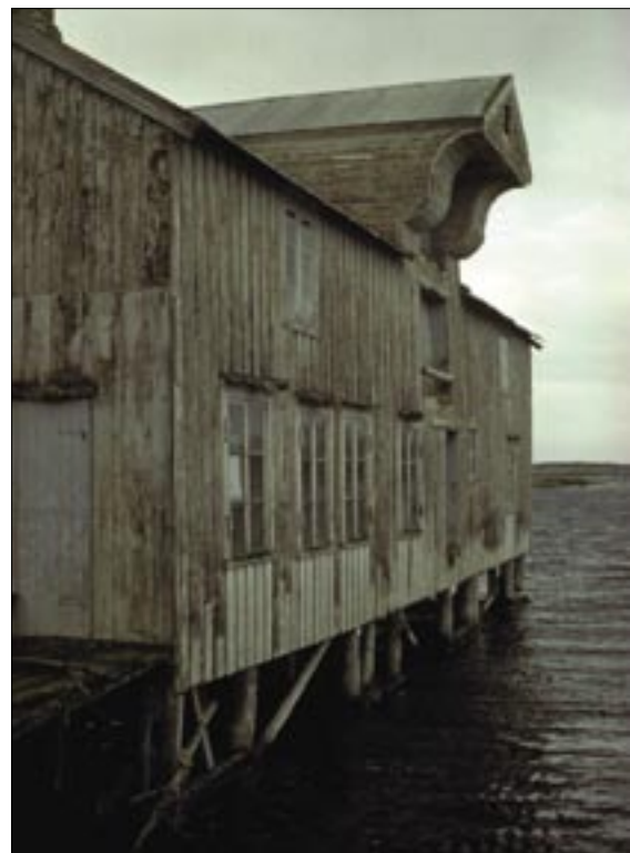
Salteribygningen på Heimværet var sterkt preget av forfall da Kystmuseet i Nord-Trøndelag Woxengs Samlinger overtok bygningen etter at den siste væreieren i Sør-Gjæslingan gikk konkurs i 1978.
